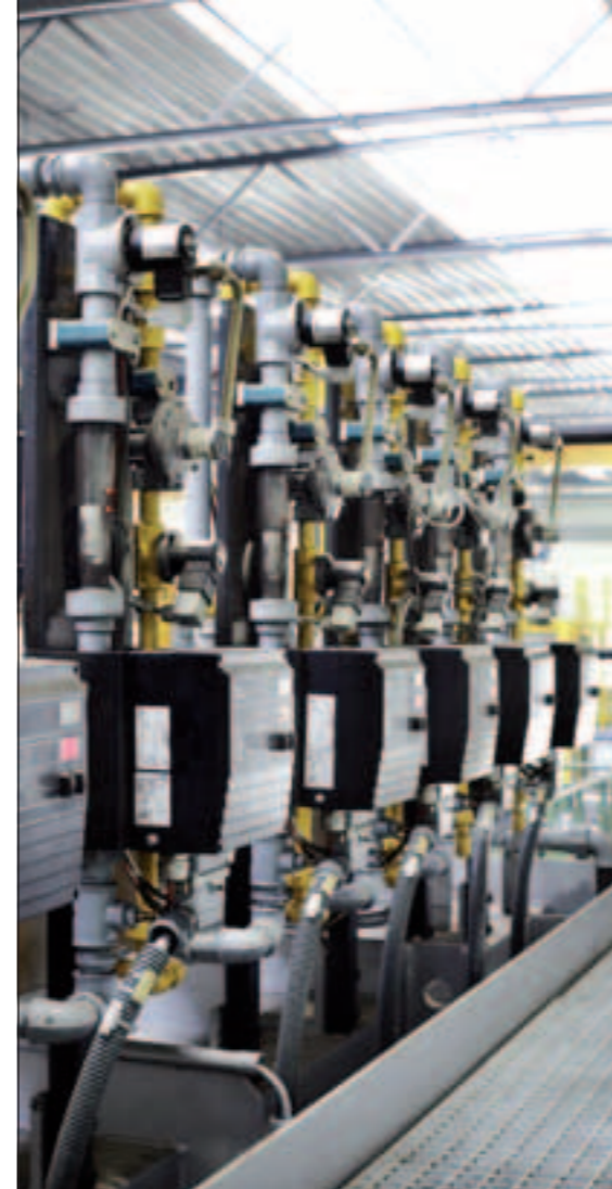
Mischbatterie und Steuerungselektronik einer Recon®-Beheizung
