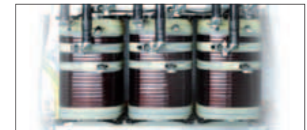
Трансформаторы с LCP Start турбины газового охлаждения
